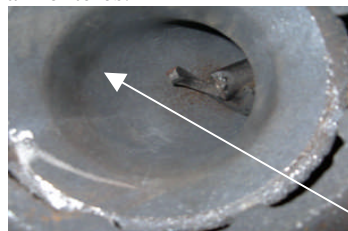
Den indvendige herd renses grundigt vær særlig opmærksom på slagger dannelse der skal fjernes.
